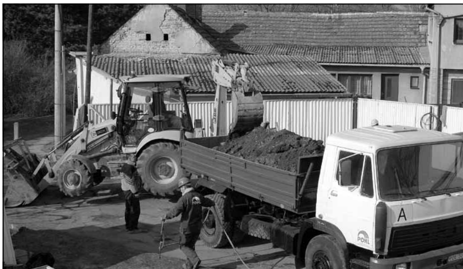
Práce na kanalizaci v lokalitě Na Rybníčku začaly ve středu 9. března. Foto -na-
