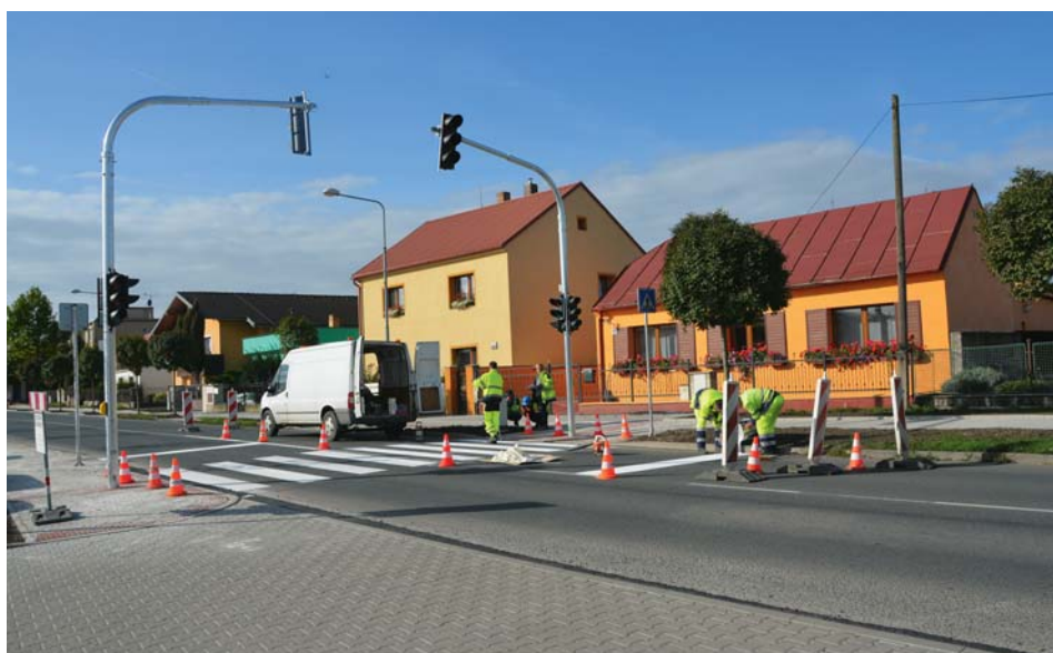
Semafor a nové značení kolem přechodu
