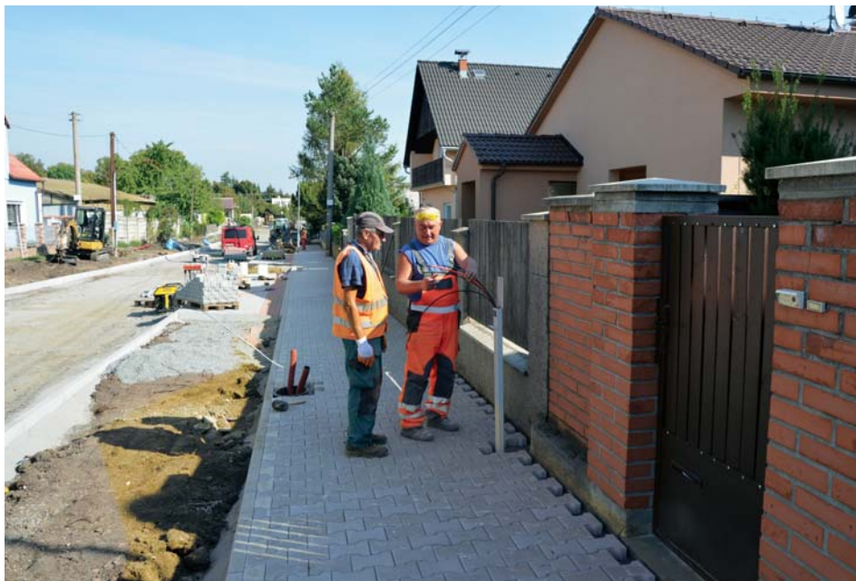
Uzlový bod optických kabelů
