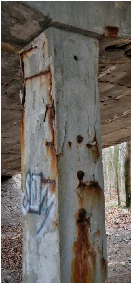
Na první pohled je vidět, v jak špatném stavu je most v Měšicích
