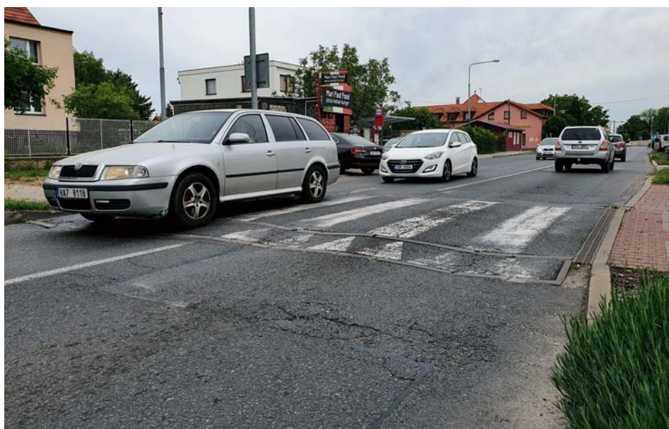
Rozbitou Mělnickou ulici čeká rekonstrukce
